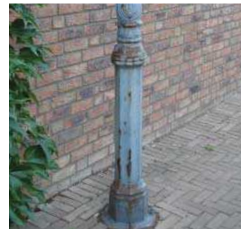
Abgeblätterte Lackierungen der Leuchtenmaste tragen zur negativen Wahrnehmung des Straßenbildes bei.
