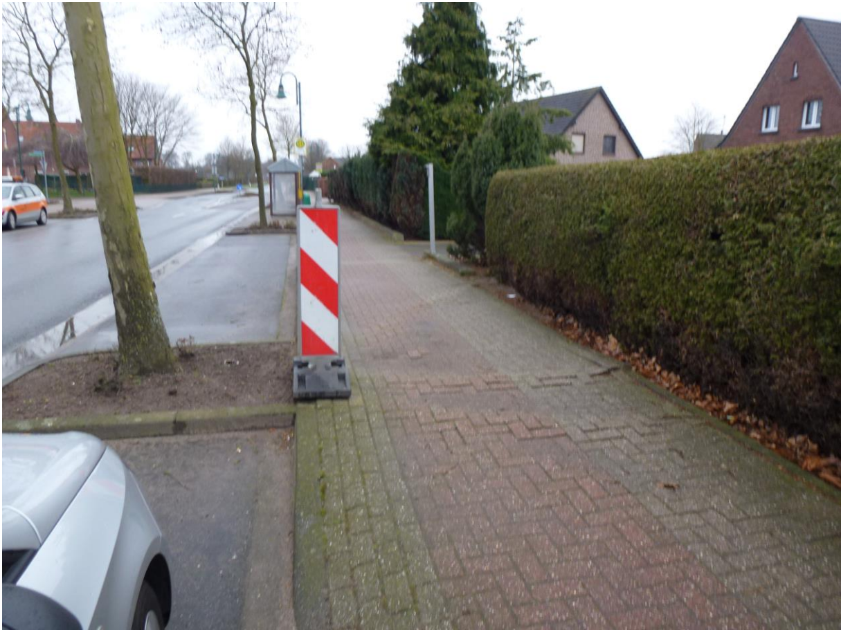
Abb. 3: Deutlich sichtbarer Wurzelverlauf unter der Pflasterung im Bereich des Rad-/Gehweges
