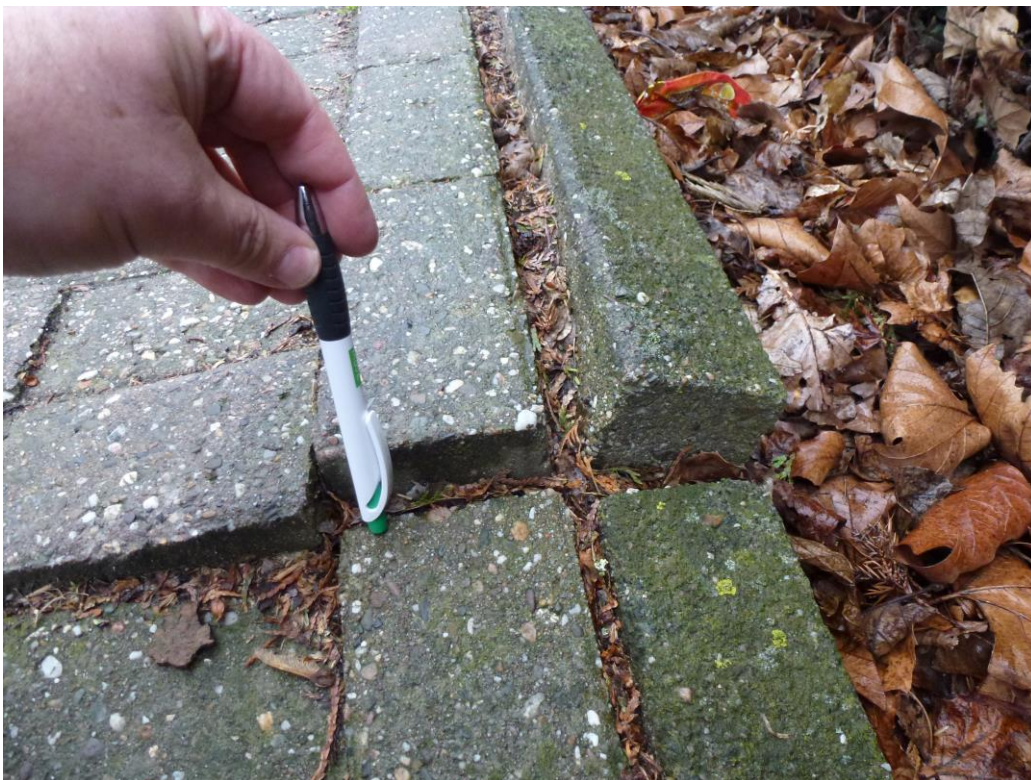
Abb. 4: Erhebliche Verwerfungen an Pflasterung und Kantsteineinfassung
