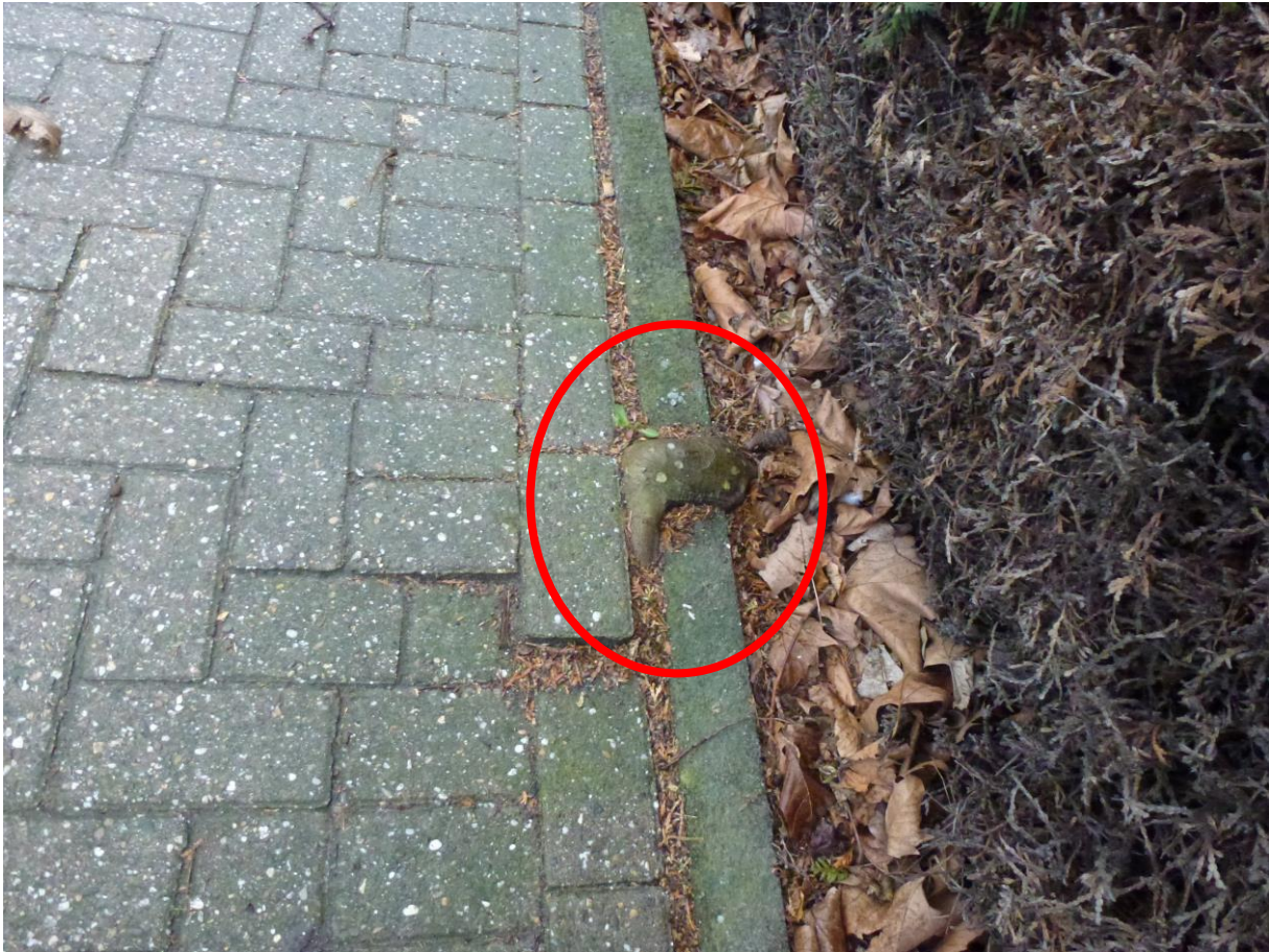
Abb. 5: Platanenwurzel überwächst die Kantsteineinfassung zum privaten Nachbargrundstück
