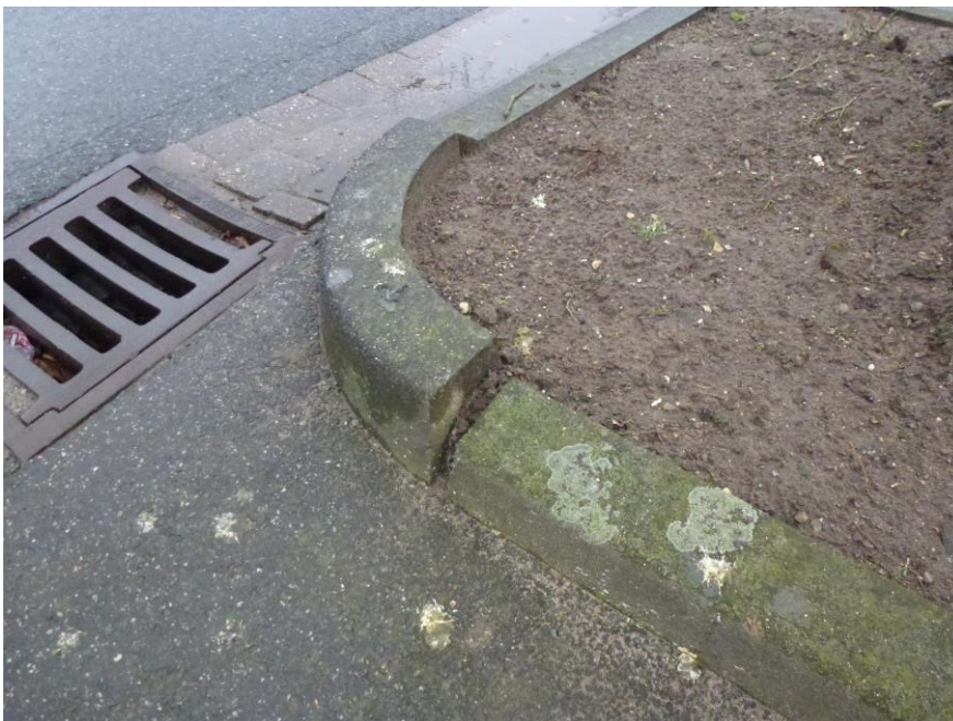
Abb. 2: Bordsteine zur Fahrbahn werden weggedrückt, Kleinpflaster in der Rinne leicht angehoben
